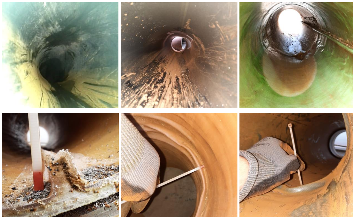
Bild 31 „Faltenbildung/Hindernisse“: Keine Auffälligkeiten bei „Compact Pipe“ (oben links) und „egeLiner“ (oben mitte); Längsfalte > 6 mm bei „Esders HPS Liner“ (oben rechts) und „SaniPipe“ (unten links); Falten > 6 mm bei „Nordiflow W PE“ (unten mitte) und „Starline Structure-S“ (unten rechts)
