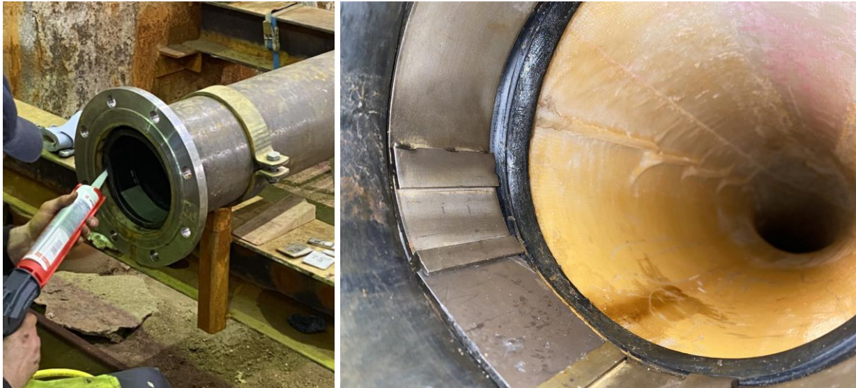
Bild 17 Neusetzen der Manschetten mit Acetat-Silikon bei „SaniPipe“: Einbringen des Dichtmittels (links), Nacharbeitsergebnis (rechts)
