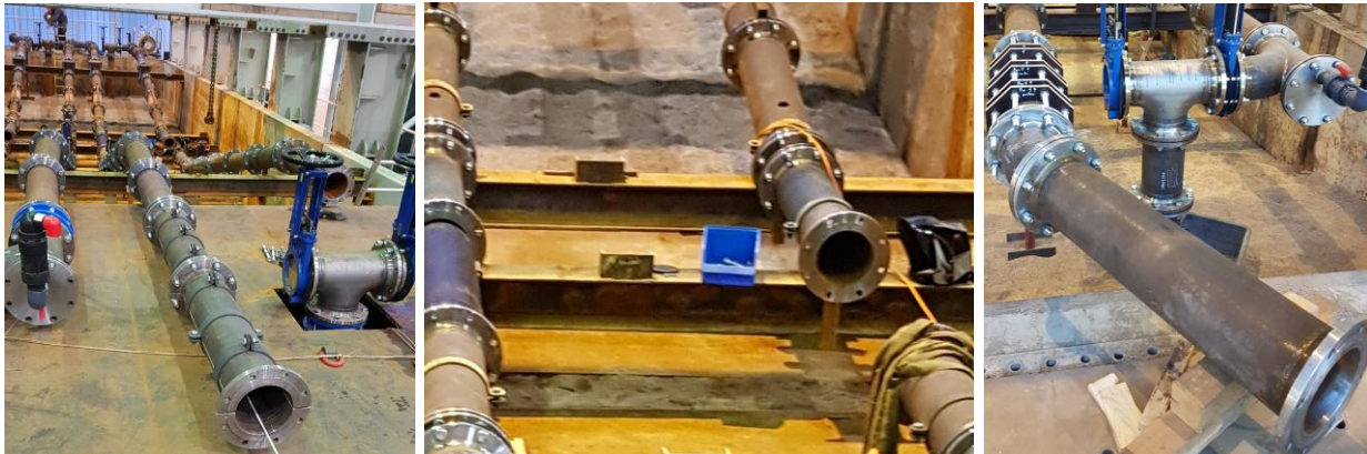
Bild 10 Um zwei ein Meter lange Stahlrohre verlängerter Einfahrbereich für die Sanierungssysteme zwecks Materialprobengewinnung (links), ausgebaute Betriebseinrichtung im rechten Leitungsstrang vor dem Einbau (mittig) und Rohre der Sonderfragestellungen für die Installation (rechts)
