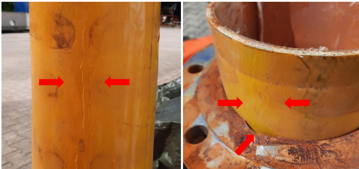
Bild 21 Tragfähigkeit der Struktur „SaniPipe“: Risse infolge Kollaps durch Luftunterdruck- und Außenwasserdruckbelastung
