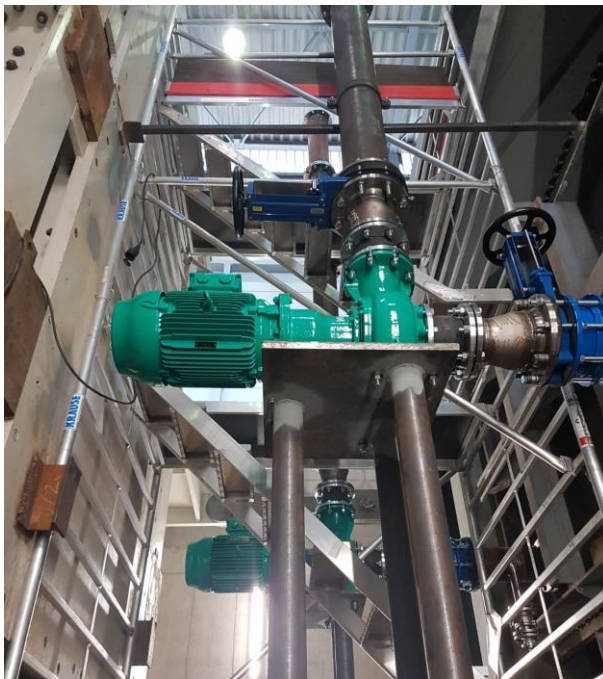
Bild 8 Pumpstation mit Auflagertisch, Steigleitung mit Schieber (nach oben abgehend) und von rechts ankommender Saugleitung ebenfalls mit Schieber
