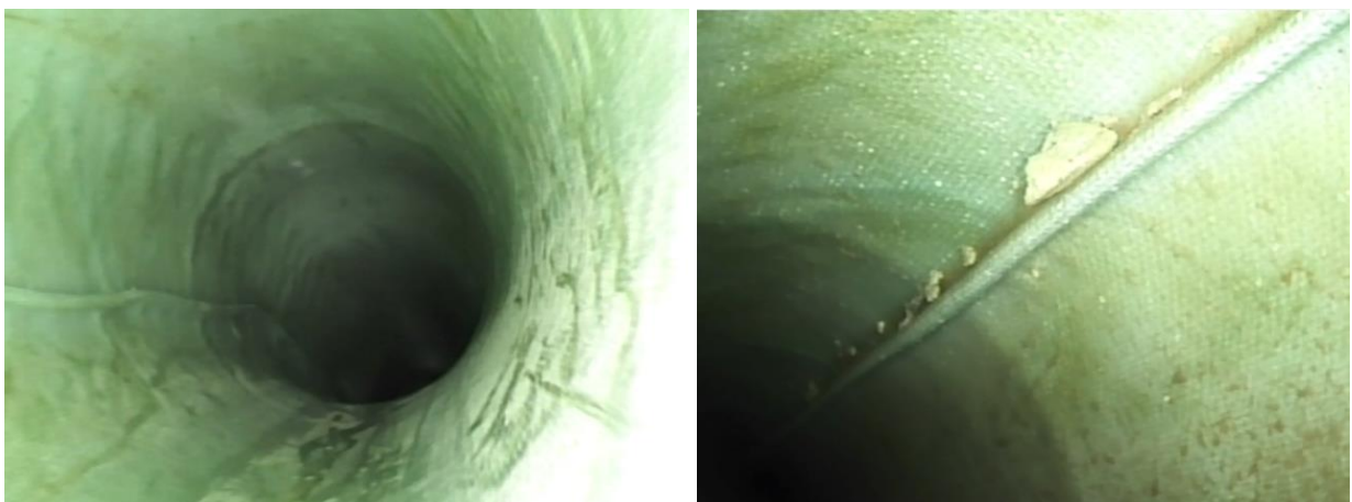
Bild 23 Optischer Gesamteindruck „Esders HPS Liner“: Durchgehende Längsfalte (links), Ablagerungen auf durchgehender Längsfalte (rechts)
