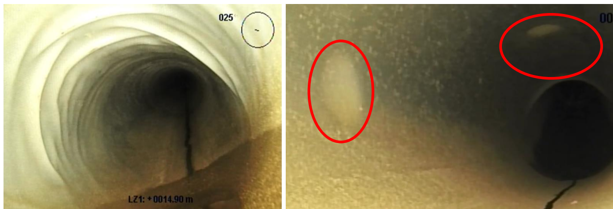
Bild 30 Optischer Gesamteindruck „Starline Structure-S“: Falten am Bogen (links), Verfärbungen (rechts)
