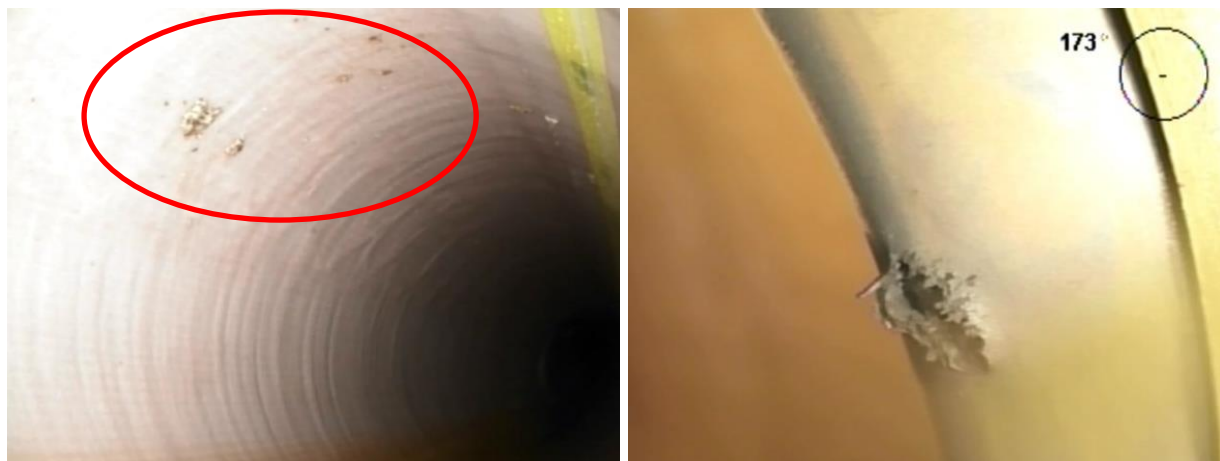
Bild 27 Optischer Gesamteindruck „Nordiflow W PE“: Ablagerungen (links), Loch im Gummi der Manschette nach HD-Reinigung (rechts)
