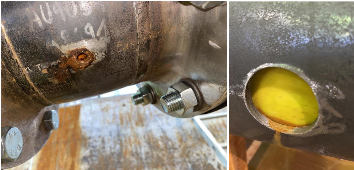
Bild 14 Exfiltrationsdichtheit: Feuchtigkeit am „SaniPipe“
