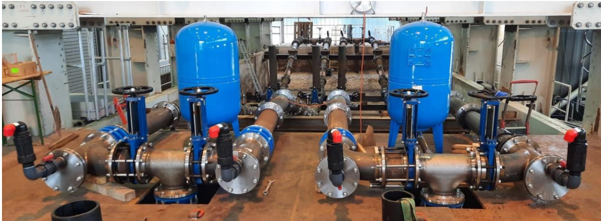
Bild 6 Blick von der vorderen Arbeitsplattform auf die eingebauten Leitungen und blauen Druckkessel
